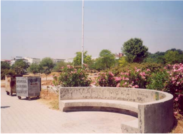
Resim 16. Bakımsız durumdaki çöp kutusu ve oturma elemanı, Zeytinburnu Parkı, İstanbul.
