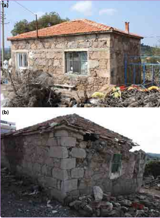
Şekil 17. Hatıllı ve hatılsız duvar örnekleri. (a) Betonarme hatıllı hasarlı yapı örneği. (b) Hatılsız hasarlı yapı örneği.
