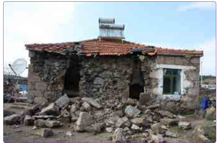
Şekil 26. Bacanın duvarda oluşturduğu hasar.
