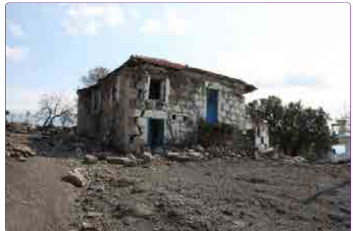
Şekil 22. Eğimli arazi üzerine yapılan hasarlı yapı.
