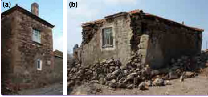
Şekil 12. Duvar köşe durumu. (a) Hasarsız köşe detayı, (b) hasarlı köşe detayı.
