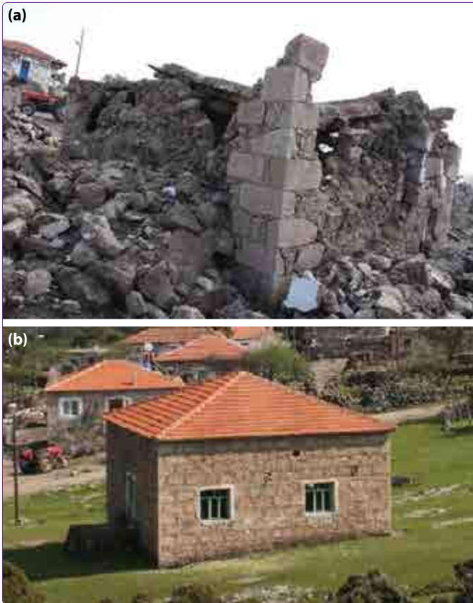
Şekil 15. Farklı dayanımlı harçlı yapıların durumu. (a) Düşük dayanımlı toprak harçlı bir yapıda oluşan hasar. (b) Çimento harç ile yapılan hasarsız yapı.
