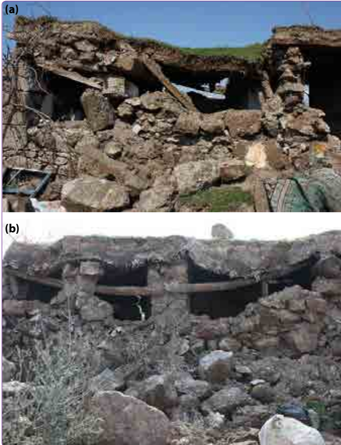
Şekil 20. (a, b) Toprak damlı hasarlı yapılar.
